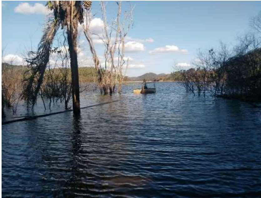
Figura 5 – Bomba flutuante dentro do Açude Público Jenipapo utilizada na captação da água do reservatório.
