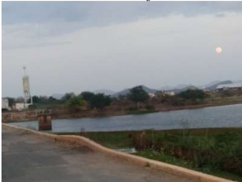
Figura 10 – Pavimento flexível ondulado, deslocando o meio fio da crista da barragem na montante da barragem.
